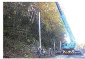
国道240号 落石対策
