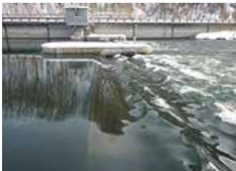
網走川大曲堰鋼製起伏ゲート起立中)
