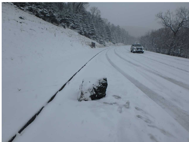
落石の状況①(全景)
