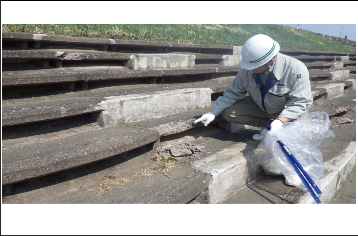
○撮影場所： 美幌町 網走川 大正橋上流左岸 KP=31.3付近 ○写真説明： 階段護岸の一部損傷を確認
