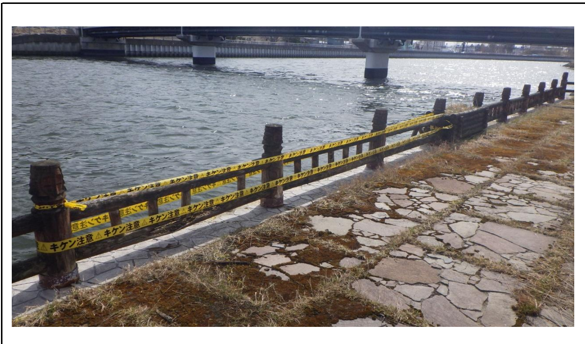
○撮影場所： 網走市 網走川 左岸 KP=3.8付近 ○写真説明： 柵の一部損傷を確認
