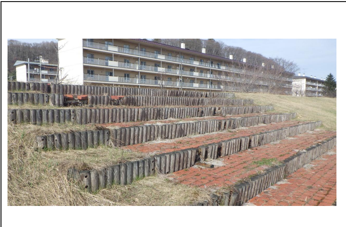
○撮影場所： 網走市 網走川 左岸 KP=3.8付近 ○写真説明： 階段護岸の一部損傷を確認
