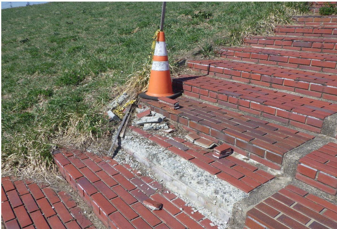
○撮影場所： 北見市 常呂川 左岸 KP=47.0付近 ○写真説明： 階段護岸の一部損傷を確認
