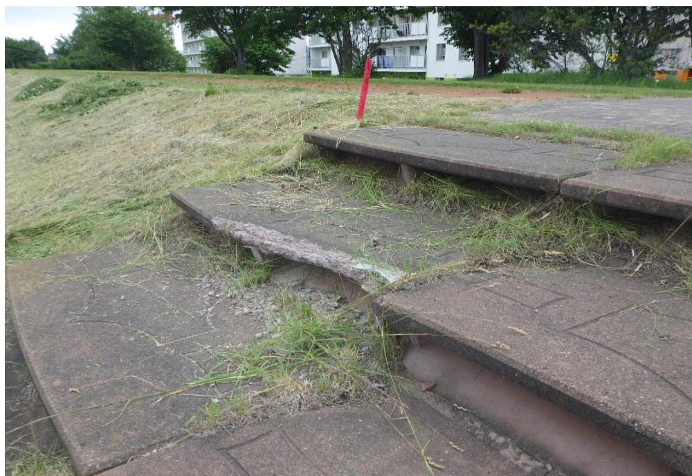
○撮影場所：北見市 常呂川 左岸 KP=46.8付近 ○写真説明：階段護岸の一部損傷を確認
