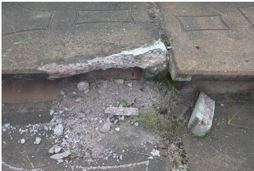
○撮影場所：北見市 常呂川 左岸 KP=46.8付近 ○写真説明：階段護岸の一部損傷を確認
