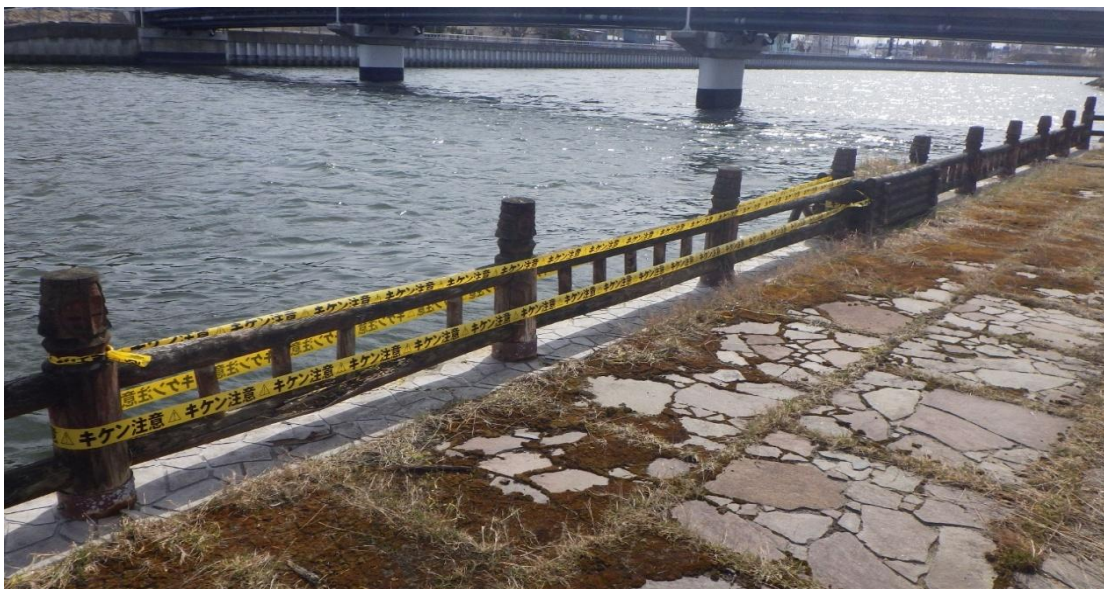
○撮影場所：網走市 網走川 左岸 KP=3.8付近 ○写真説明：柵の一部損傷を確認
