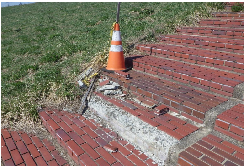
○撮影場所：北見市 常呂川 左岸 KP=47.0付近 ○写真説明：階段護岸の一部損傷を確認
