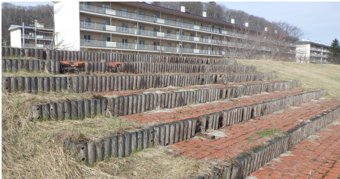
○撮影場所：網走市 網走川 左岸 KP=3.8付近 ○写真説明：階段護岸の一部損傷を確認
