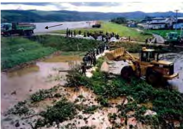
平成 4 年 9 月洪水の状況 (北見市 常呂地区基盤漏水への対応)
