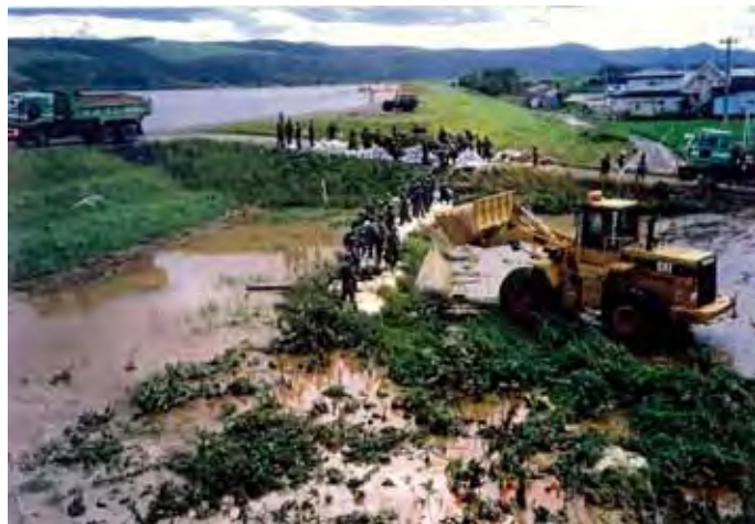
平成4年9月洪水の状況 (常呂地区基盤漏水への対応)
