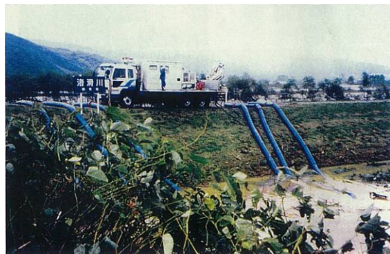
平成 10 年 9 月洪水の状況 (ウツツ地区の内水排除状況)
