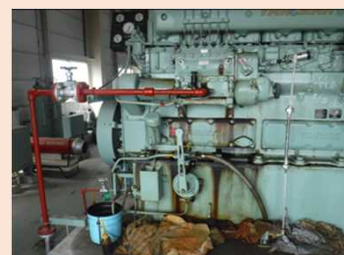
ポンプ原動機の漏油
