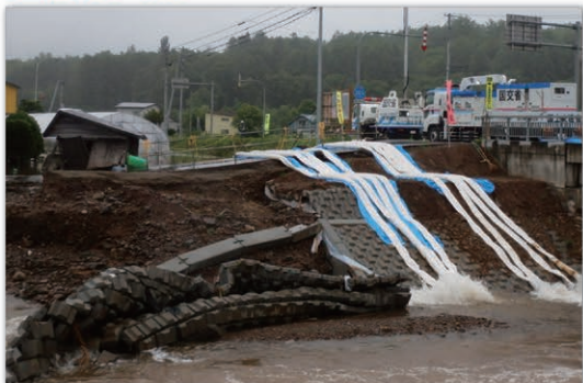
令和4年6月28日からの大雨による災害対策用機械の支援状況（令和4年6月旭川市）
