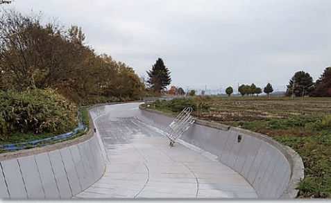
改修整備後の用水路 (国営かんがい事業 当麻永山用水地区)
