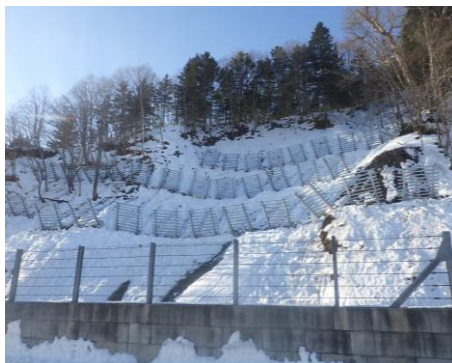
防雪対策（国道275号 幌加内町）
