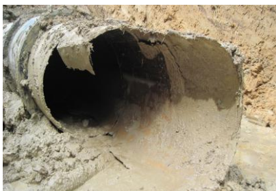
経年劣化により破損した用水路
