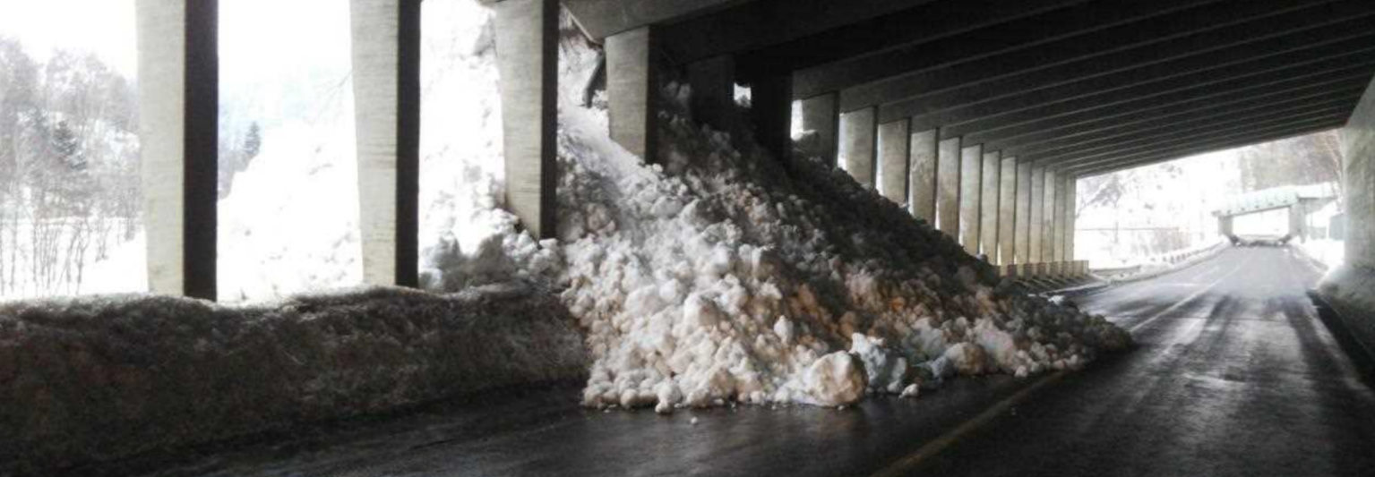
国道40号（特殊通行規制区間） （音威子府村物満内 令和5年3月8日雪崩状況）
