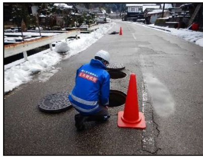
【被災施設の調査】
