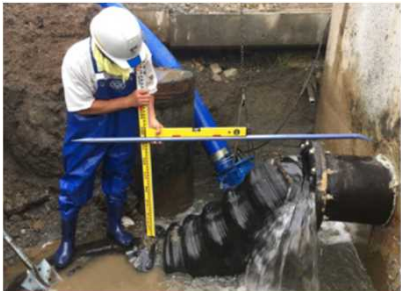
沈下による可とう管の亀裂・破断
