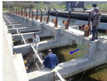
(5/11) 本川との接続箇所 ドラムスクリーンの稼働状況
