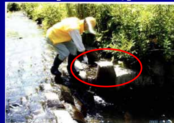
魚道部の土砂埋塞状況
