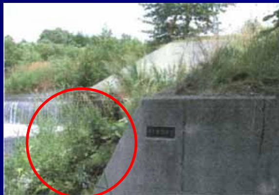
魚道部の土砂埋塞状況
