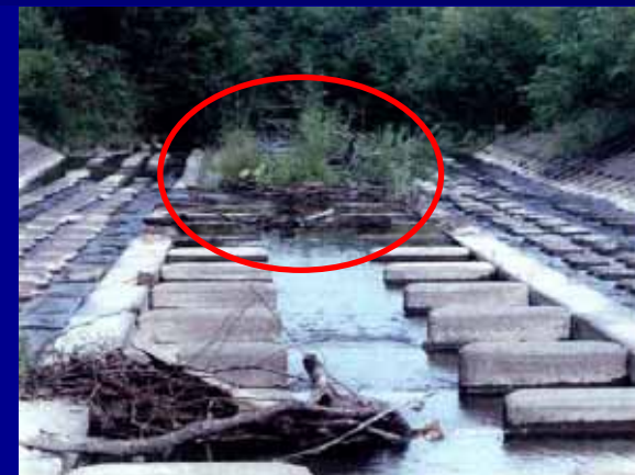
魚道部の土砂埋塞状況
