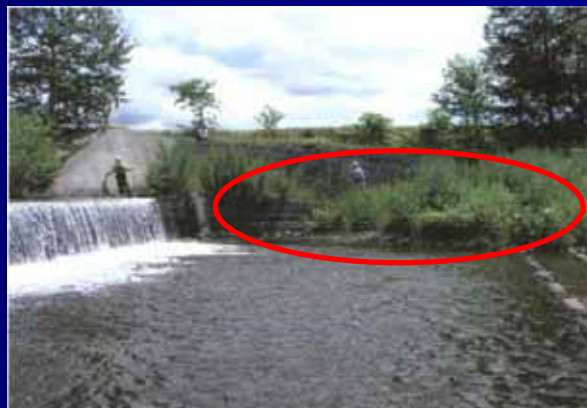
魚道部の土砂埋塞状況
