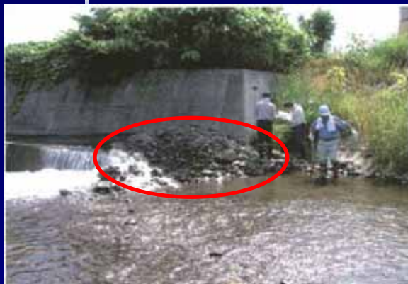
魚道入口部の土砂堆積状況
