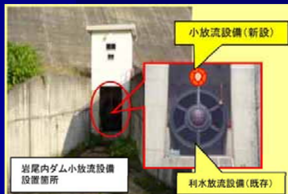
岩尾内ダムの小放流設備
