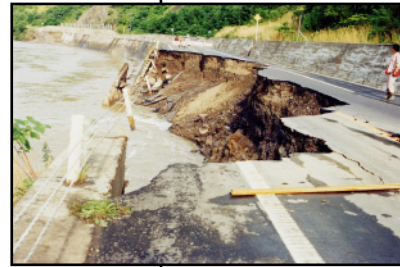
天塩川左岸 決壊した国道 (中川町富和地先)
