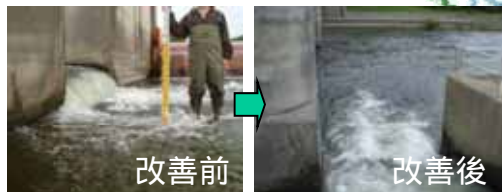
真勲別頭首工 (魚道改善)
