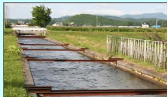
側壁傾倒により改修が必要な幹線用水路
