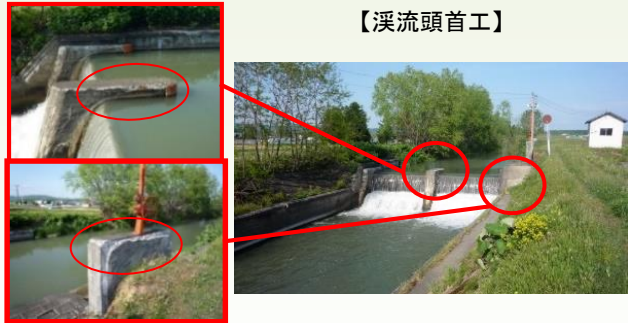
廃止する溪流頭首工は造成後50年以上が経過しコンクリートの凍害・ひび割れ及び鉄筋露出が発生
