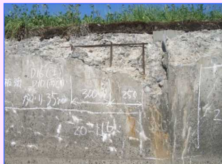
側壁部の凍害ひびわれ・欠損・剥落
