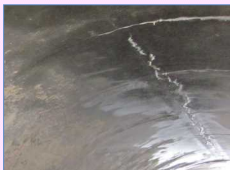
覆工面ひび割れ
