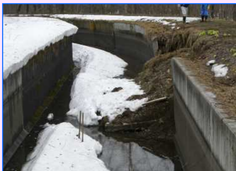
側壁部の倒壊
