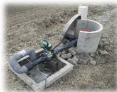
集中管理孔と給水栓
