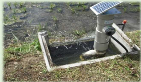
自動給水栓による 水管理システムの導入
