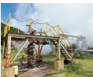
奥尻地熱発電所「地熱生産井」
