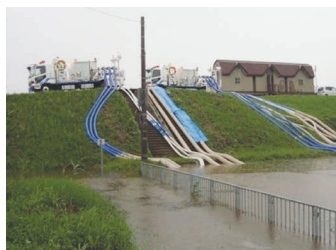
排水ポンプ車
