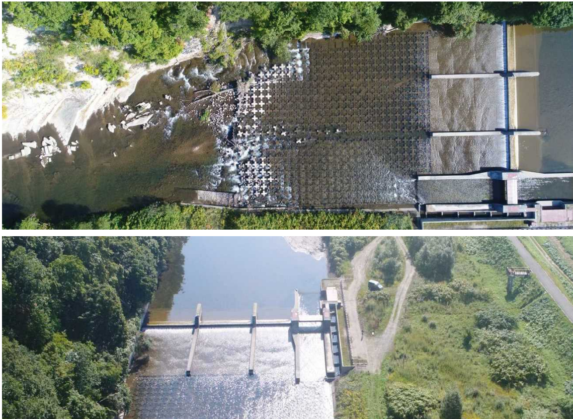
写真-1 住吉頭首工の現状
