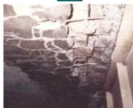
●橋が壊れている様子。
