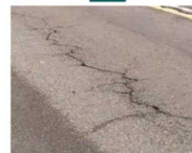
●舗装のひび割れの様子。
