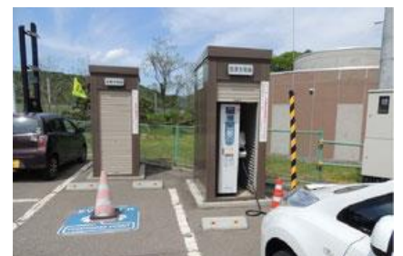
道の駅EV充電施設設置状況
