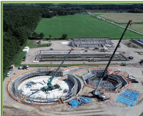
肥培かんがい施設整備状況(別海北部地区)
