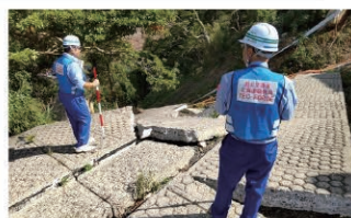
令和6年 能登半島地震による被災状況調査(石川県輪島市)
