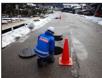
【被災施設の調査】
