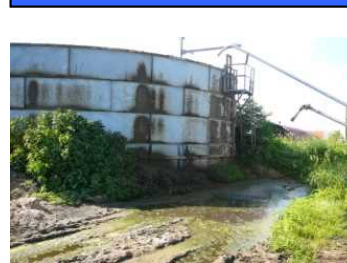
老朽化した配水調整槽
