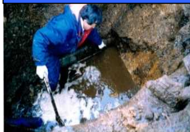
老朽化による漏水
