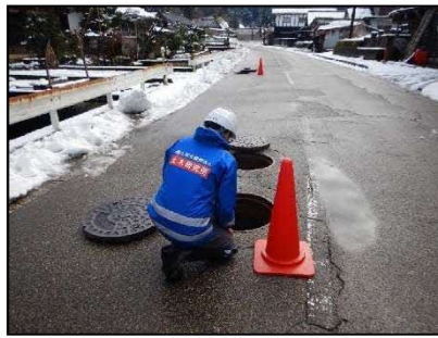
【被災施設の調査】
