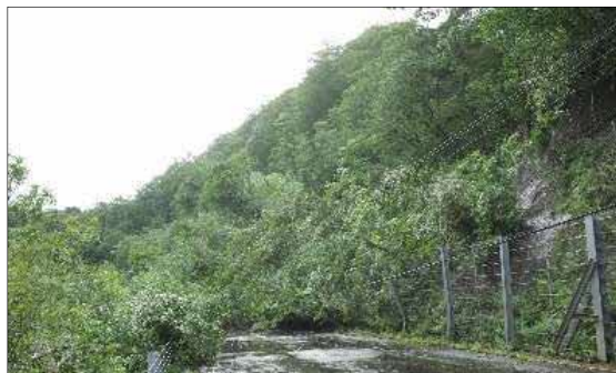
【表層崩壊箇所の現地状況】
