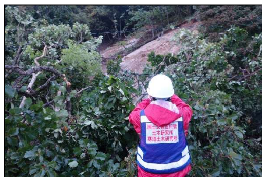
【国道付近地すべりの現地状況】
