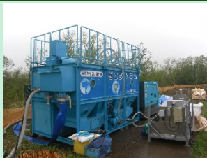
▲濁水処理装置
