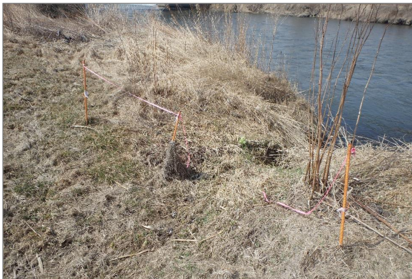
注意喚起テープ破損
