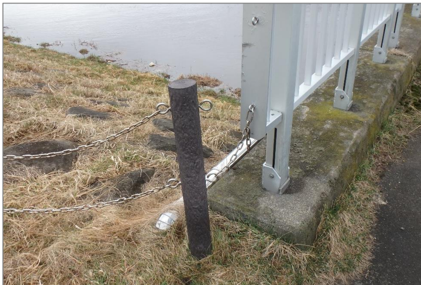
防護柵チェーンの破損
