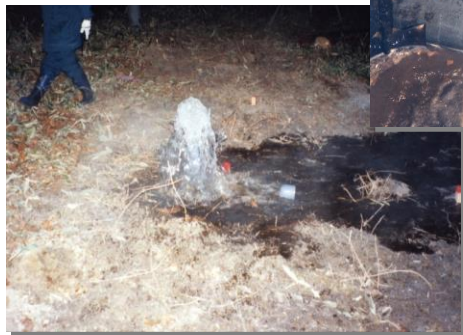
用水管の漏水状況
