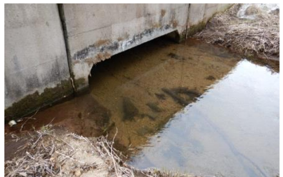
土砂堆積による排水路の機能低下
