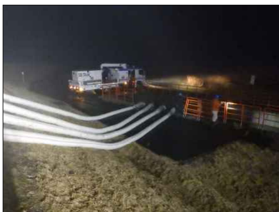
排水ポンプ車設置状況
