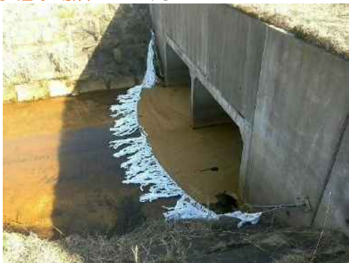
油膜流出状況の確認 （オイルフェンス設置後）
