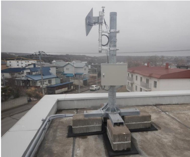
網走地方気象台設置状況
