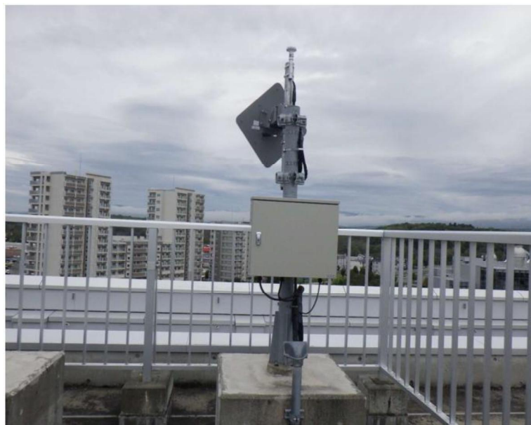
旭川地方気象台設置状況
