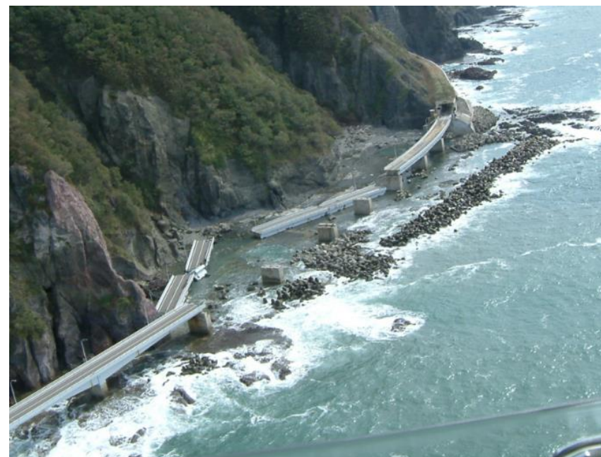
H16.9 一般国道229号大森大橋 被災状況調査〔神恵内村〕
