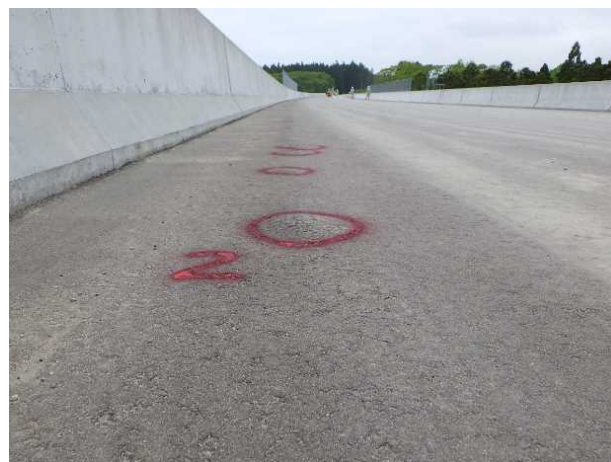
写真-1 ブリスタリング発生状況
