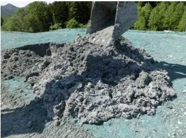
写真-2 粘土化した蛇紋岩(音中トンネル起点)
