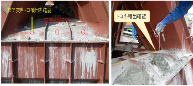
写真-1 梁水平部の空気抜孔3穴よりトロ確認
