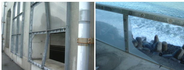
写真-2 覆道板の破損
