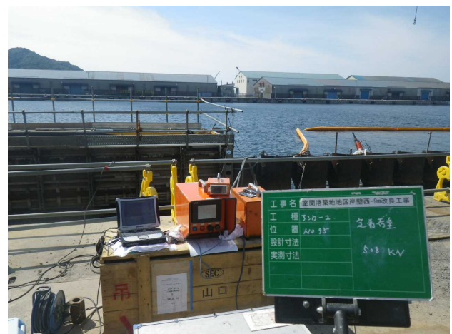
図-12 設計荷重定着状況
