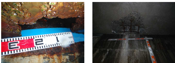
写真-1 栈橋の劣化状況
