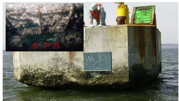
写真-1 鉄筋コンクリート構造物の海水等による劣化状況 (サロマ湖漁港 第1湖口)
