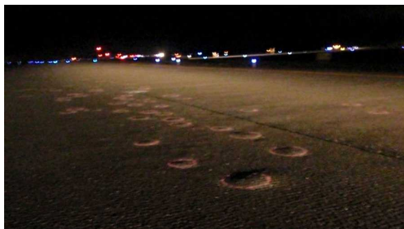
図-2 発生状況写真（平成18年6月）
