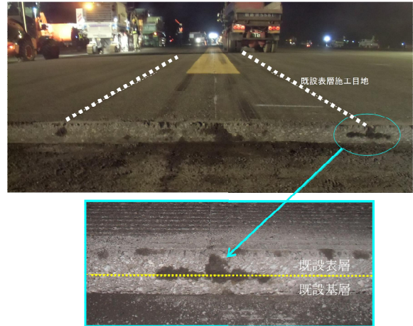
図-9 施工目地からの雨水浸透
